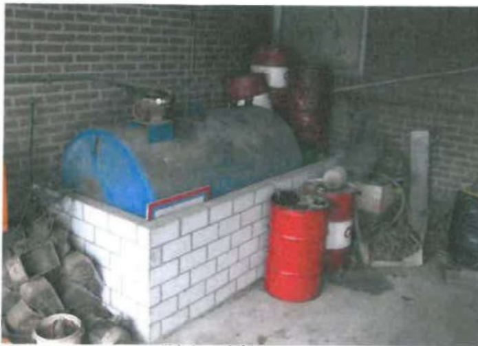
Foto 4: bovengrondse dieseltank (1.200 liter)
