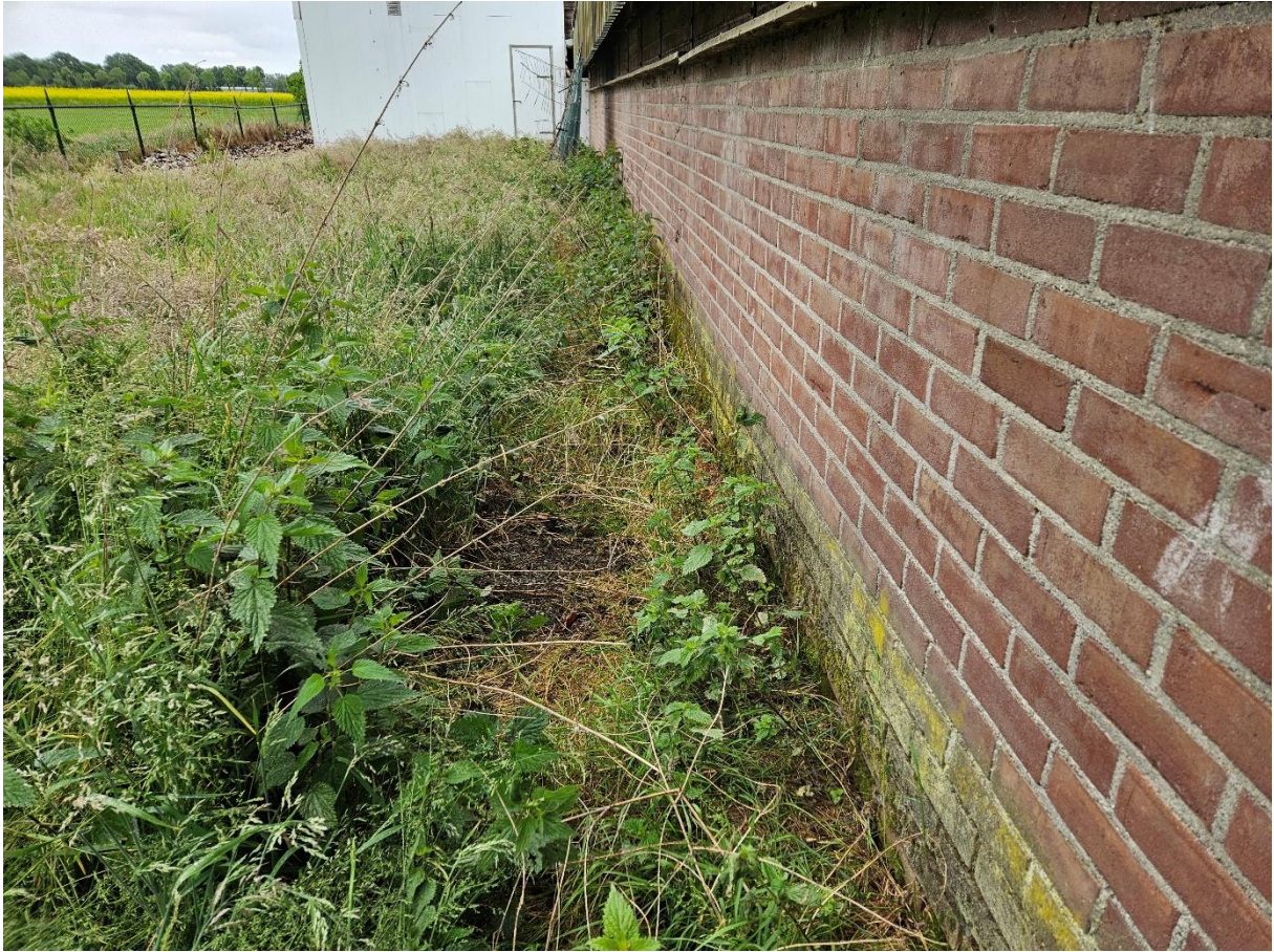
overwoekerde verharding ter plaatse van druppelzones
