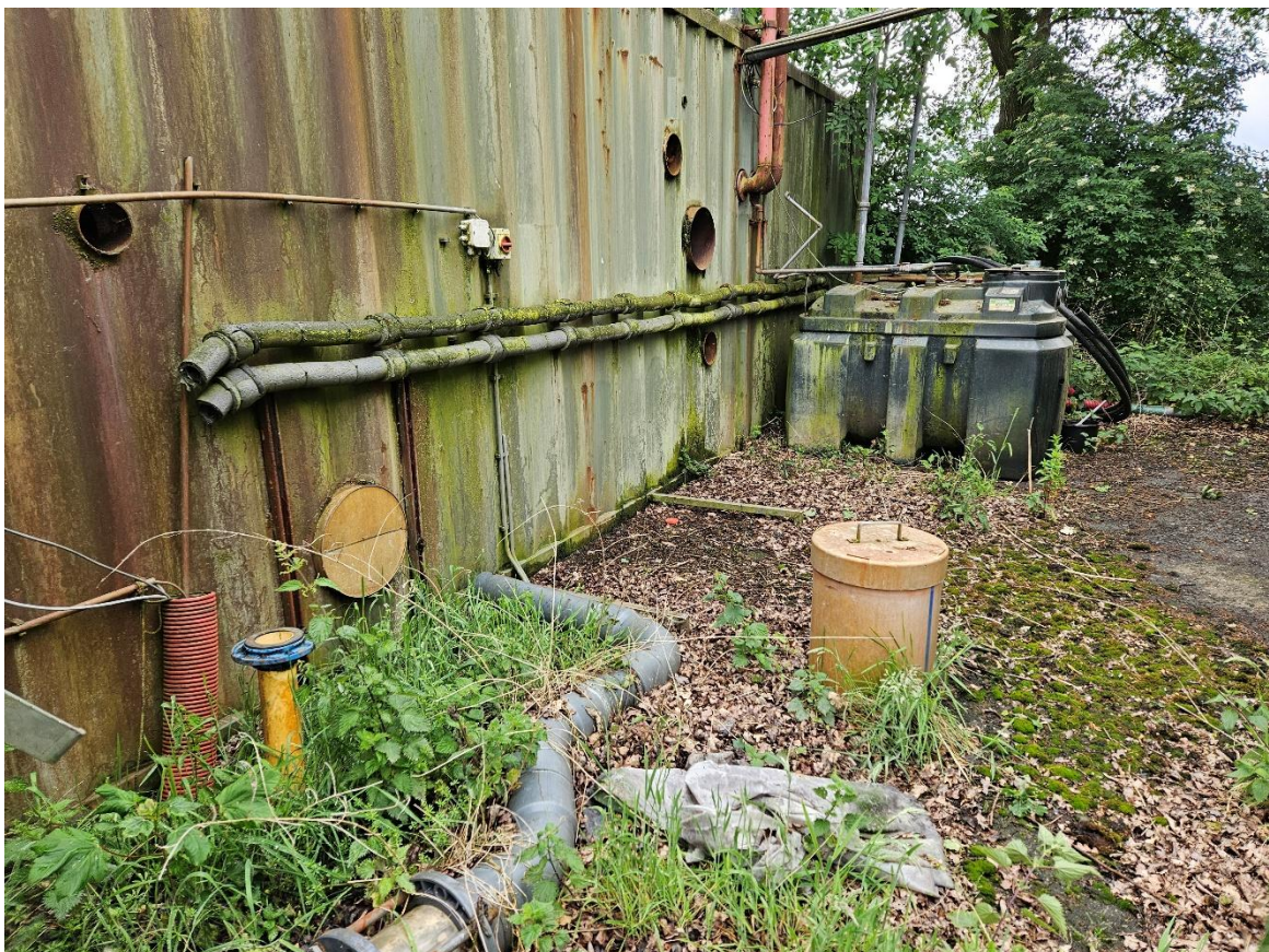
twee naast elkaar gelegen bovengrondse dieseltanks
