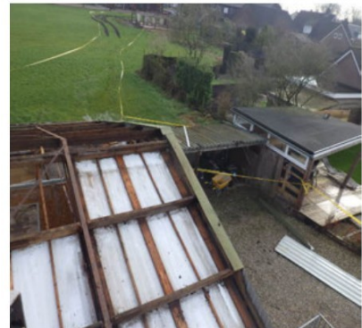
Foto 3 C / Verwijderde bron M 3
