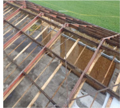
Foto 3 B / Verwijderde bron M2
