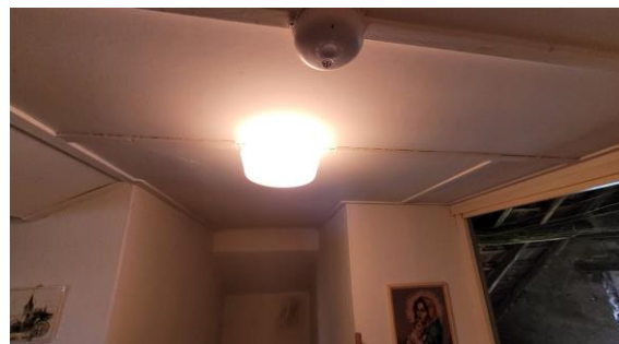
plaat als plafond aanwezig overloop
