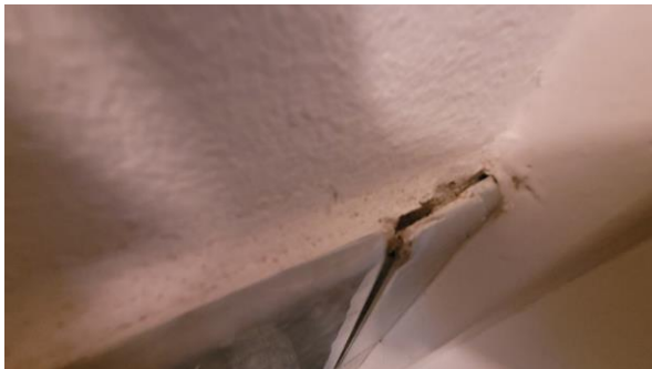
wand toilet niet verdacht
