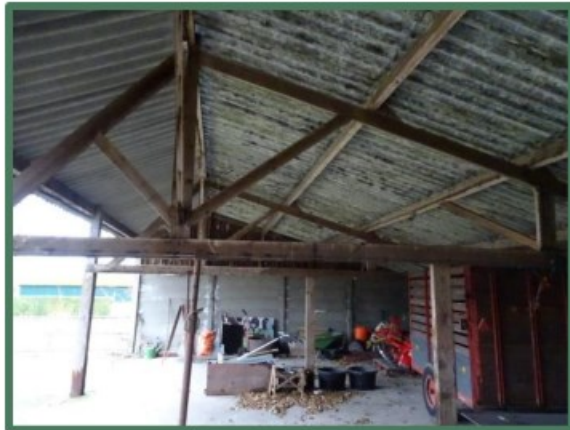
Foto 21: Geen dakbeschoot in halfopen schuur.
