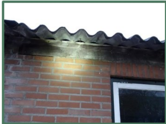
Foto 22: Muurplaat oude stal.
