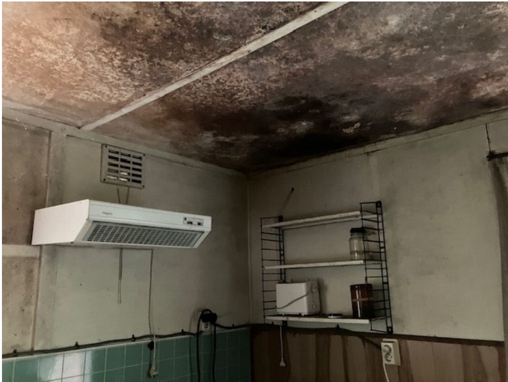
• Afbeelding 17: Vochtig plafond in het vakantiehuisje
