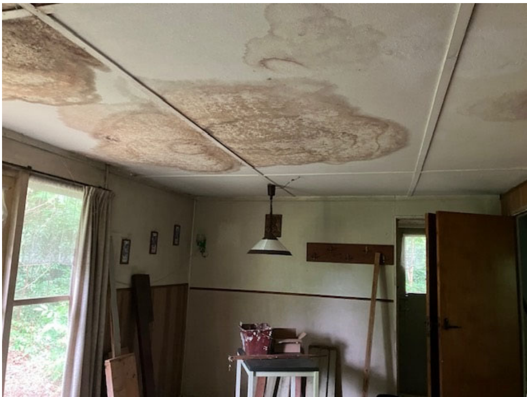
• Afbeelding 16: Vochtige binnenzijde vakantiehuisje
