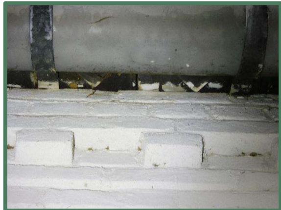
Foto 39: Platte dakpannen liggen direct op gevels, zonder openingen werkplaats/showroom.
