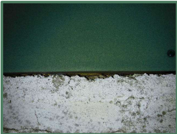
Foto 38: Houten lat achter trespas gevelbekleding werkplaats.
