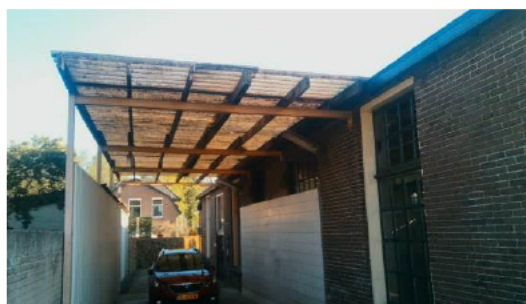
Wasstraat polyester golfplaten
