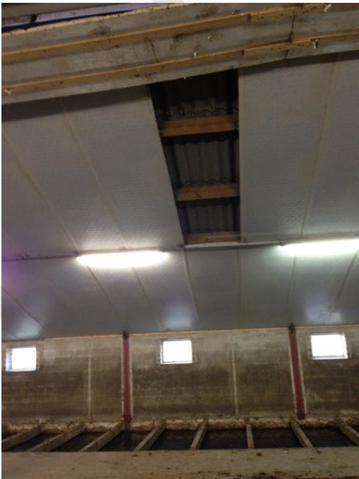
Afwezige isolatieplaat Locatie 3
