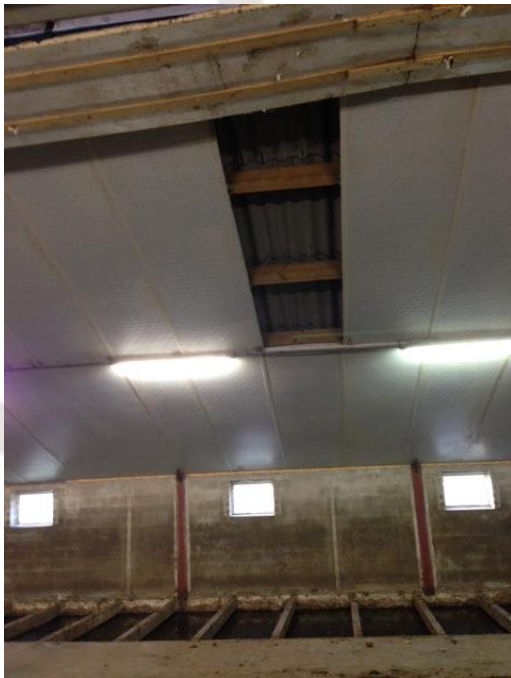
Afwezige isolatieplaat Locatie 3
