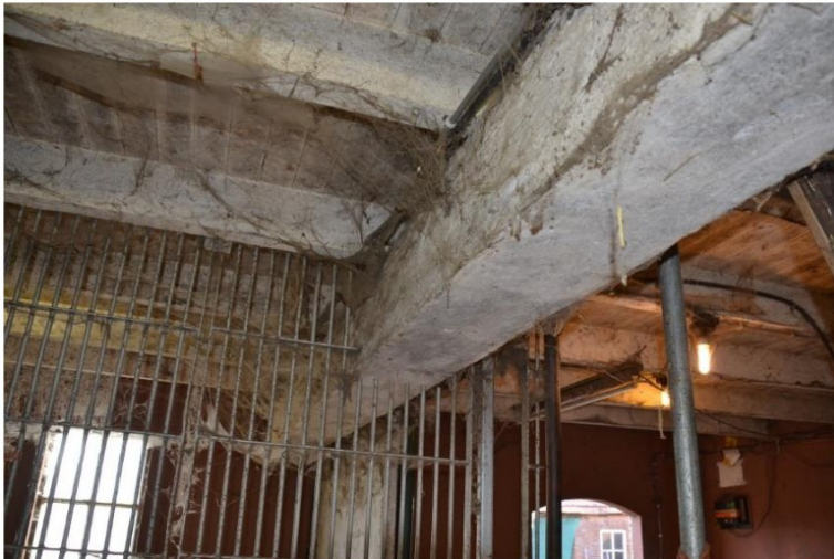
Een op de gevels afdragende moerbalk van gewapend beton met houten verdiepingsvloer.
