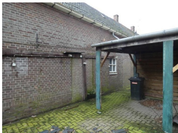
Dichtgemetselde staldeur in de achtergevel.
