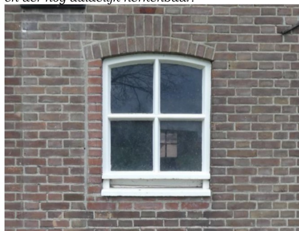
De jaren vijftig-zestig betonvensters zijn in het oorspronkelijke vensteropening geplaatst, met behoud van de segmentboog met kuif.
