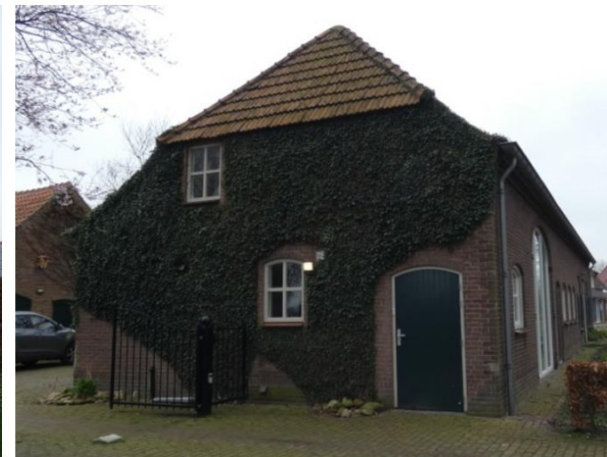
De oostelijke kopgevel met wolfseind. De staldeur rechts is later toegevoegd. De sporen van de voormalige staldeurtjes zijn nog herkenbaar.
