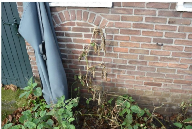
Detail van de dichtgezette varkensdeuropening. De duimen zijn nog in het metselwerk aanwezig.
