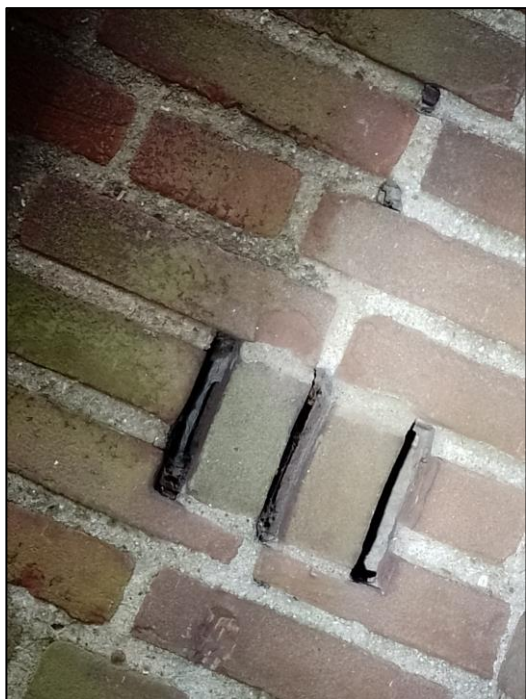
Figuur 11 voorbeeld van een van de stootvoegen waar de opening naar de spouw te zien is bij Martha gebouw
