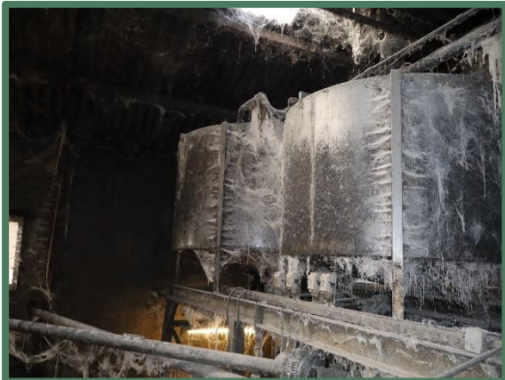
Foto 13: Binnenzijde ontluchtingssysteem varkensstallen.
