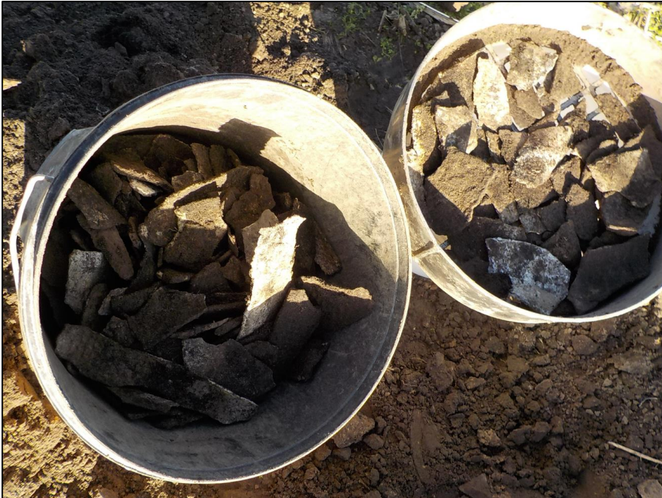
Foto 9: Asbesthoudend plaatmateriaal uit asbestinspectiesleuf SL5
