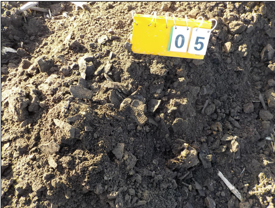
Foto 8: Asbesthoudend plaatmateriaal in vrijkomende grond uit asbestinspectiesleuf SL5
