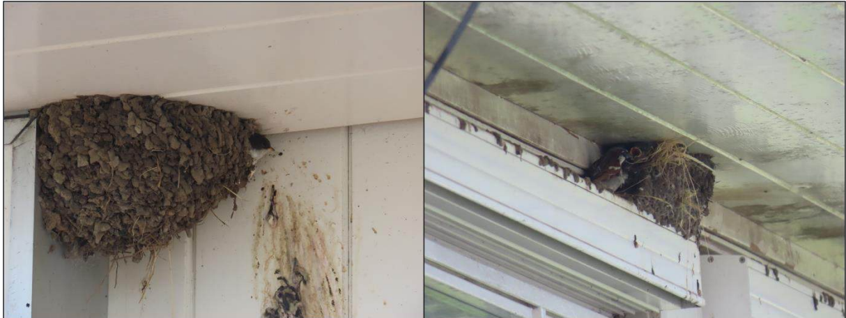
Figuur 2.1. Bewoonde nesten van een huiswaluw (links) en een huismus (in een oud huiswaluwnest, links) onder de dakrand van het voormalige hotel.
