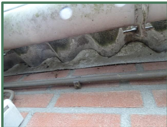
Foto 32: Metalen plaat onder golvingen dak.
