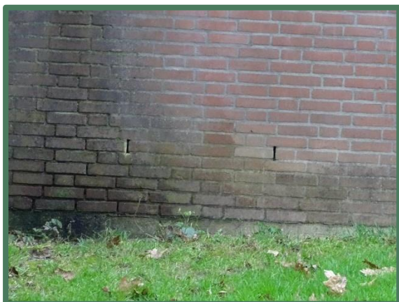
Foto 27: Open stootvoegen laag bij de grond.
