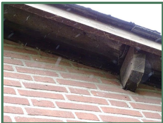
Foto 33: Strak aansluitende houten plaat en golpingen van dak liggen strak op houten overstek.
