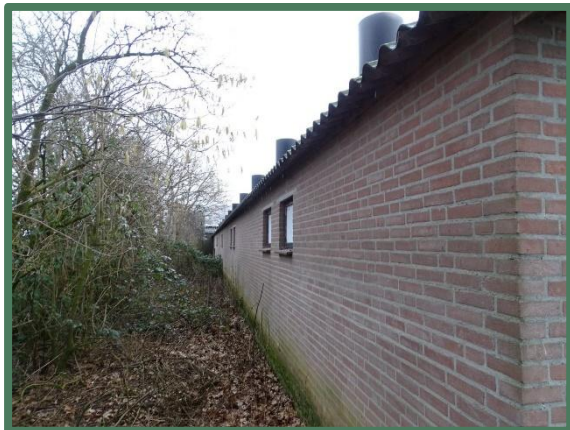
Foto 5: Oostzijde van een van de te slopen stallen.
