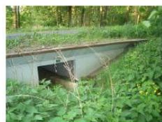
Faunatunnels onder N487
