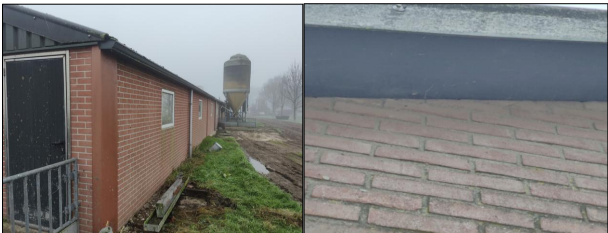
Foto 2 (links): De gevels van enkele stallen bestaan uit prefab elementen. Foto 3 (rechts): de dak overstek kiert niet op het metselwerk.
