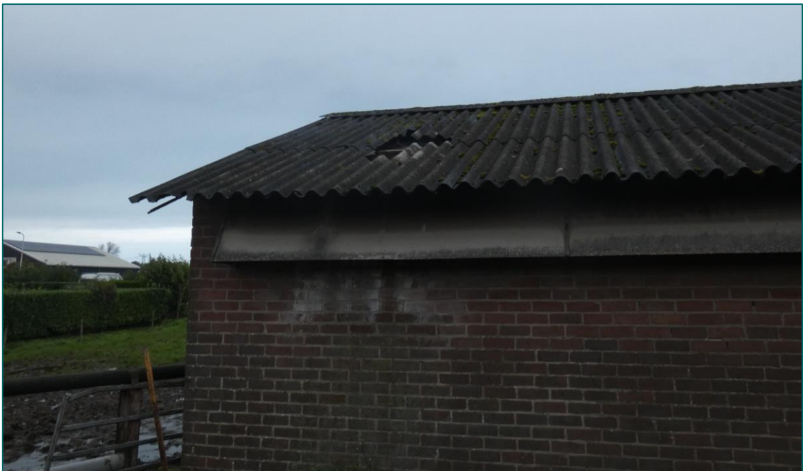
Figuur 2 Schuur 1 bestaat uit bakstenen muren zonder luchtspouw en heeft een golfplaten dak met dakbeschot. Er zijn meerdere openingen aanwezig om de bebouwing te betreden, zoals het gat in het dak in de foto waardoor uilen toegang tot de schuur hebben.
