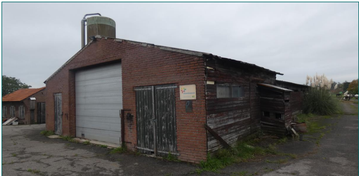
Figuur 1.3 Op de planlocatie is men voornemens om onder andere afgebeelde schuur (2) te slopen.
