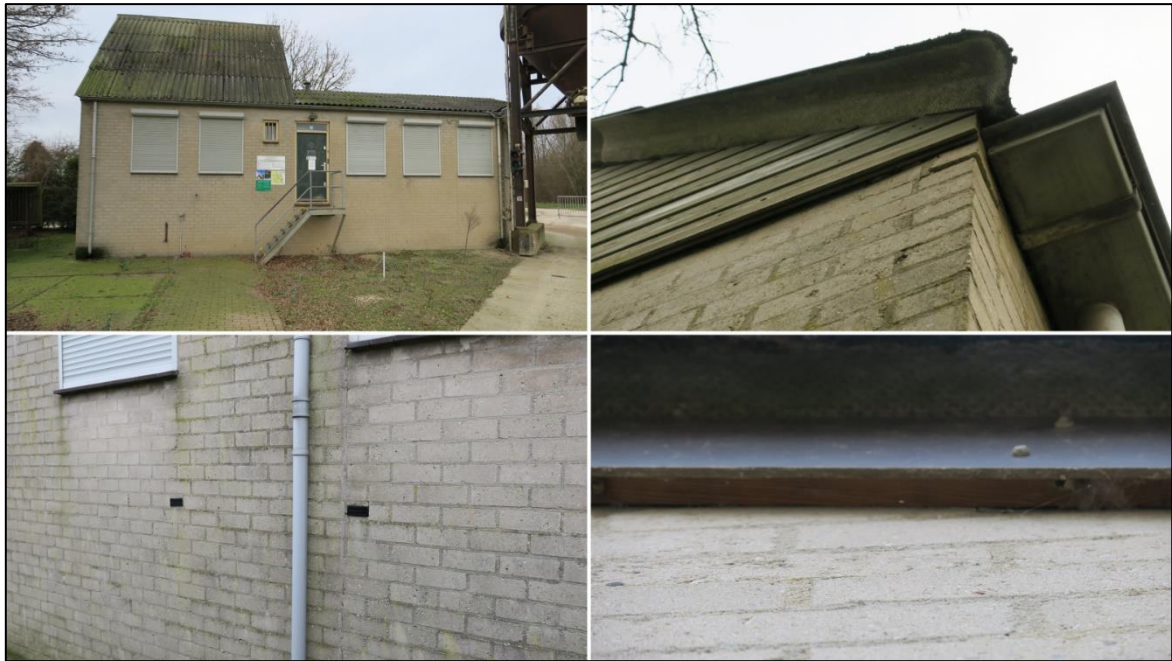
Figuur 3.3 Het gebouw op de planlocatie bevat geen geschikte invliegopeningen voor vleermuizen. Deze zijn afgesloten met een houten afwerking of ventilatieroosters.
