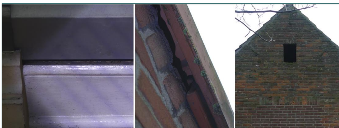
Figuur 3.1 De kier achter de dakgoot (links) en kierende kantpanen (midden) van de woning. Opening in de zijgevel van de schuur (rechts).
