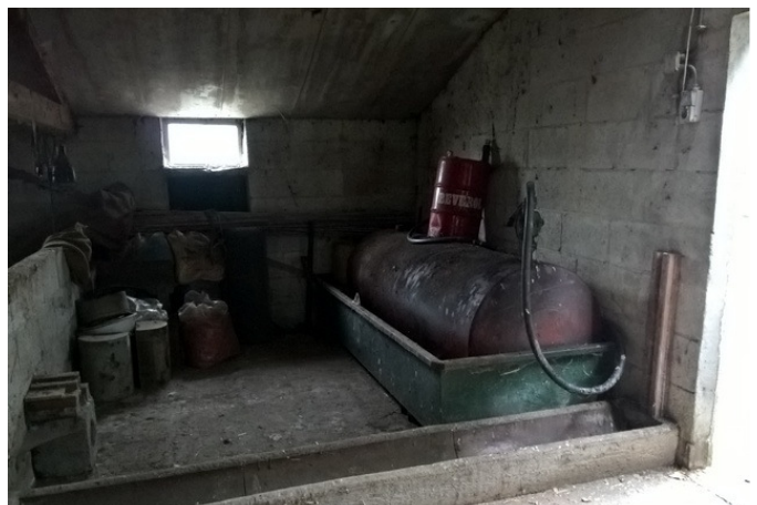
Foto 6: bovengrondse dieselolietank in lekbak, zuidzijde voormalige varkensschuur
