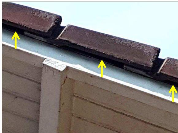
Figuur 17. Overhangende kantdakpannen
