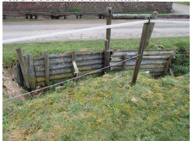
Foto 4. Asbestplaten in sloot op onderzoekslocatie
