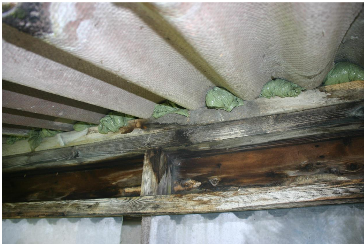
Figuur 3. De meeste openingen onder het schuurdak zijn afgedicht.
