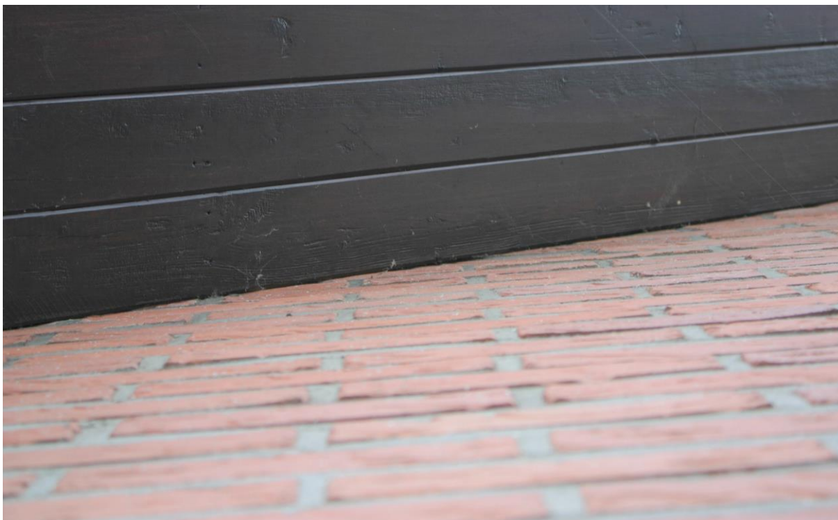
Figuur 4.2.1. De daktimmering kiert niet met de gevel, waardoor de achterliggende ruimte niet bereikbaar is voor vleermuizen.
