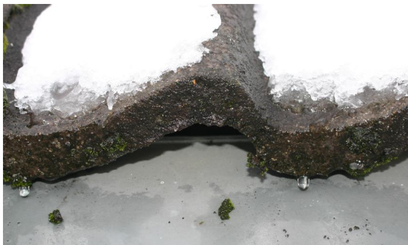
Figuur 4.2.3. De goot loopt steil naar boven onder de dakpannen. Onder de onderste rij dakpannen is er daardoor weinig ruimte en deze ruimte is lastig te verlaten.
