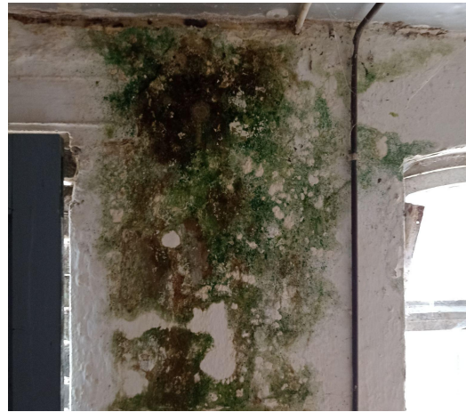
Vochtschade binnenmuur voerhuis
