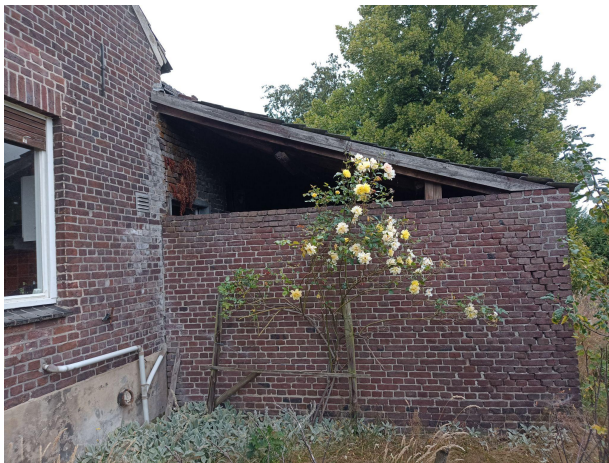
metselwerk meststal met vochtschade
