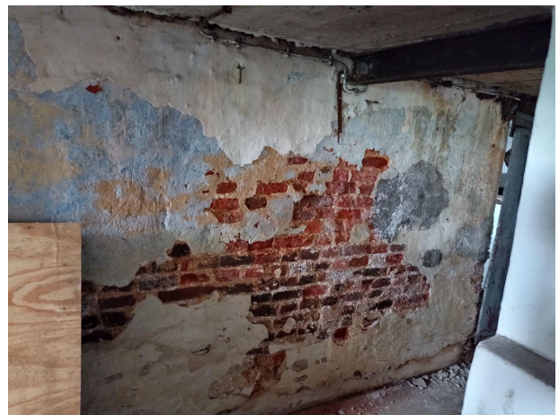
Lekkage schade muur varkensstal
