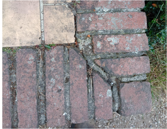
scheur in talud
