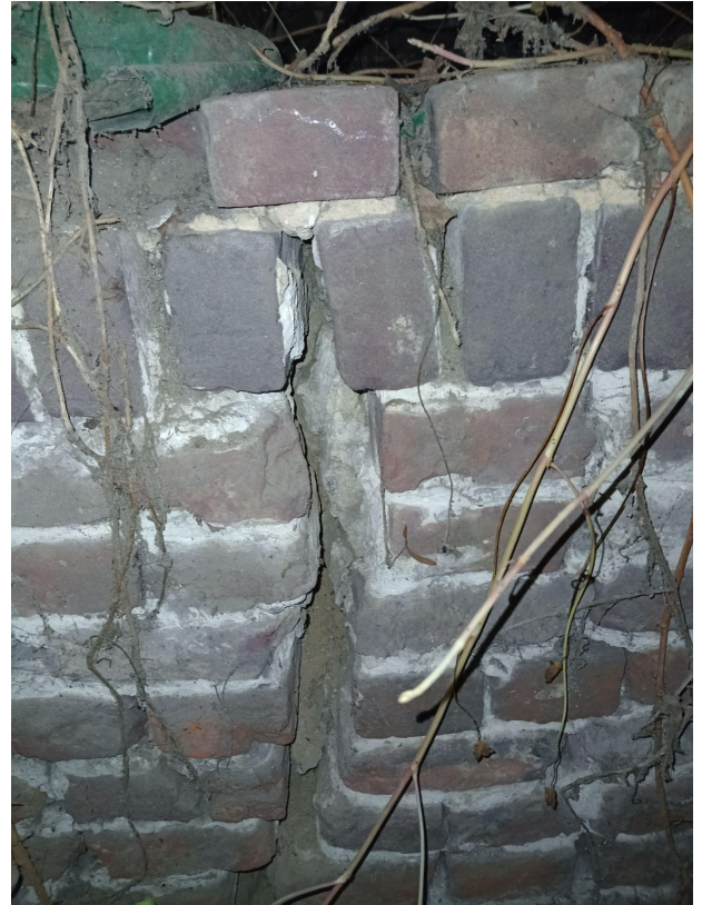
Scheur aan zijkant oven bakhuisje
