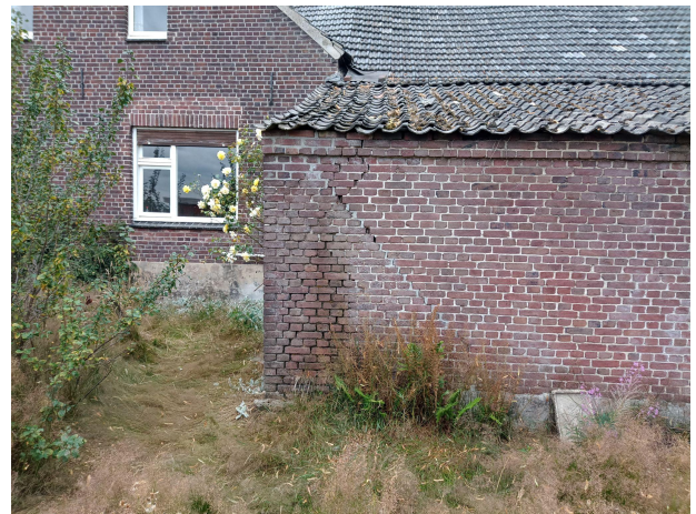
Scheur in metselwerk meststal
