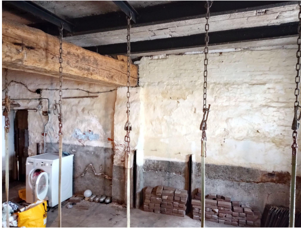
Vochtschade muur koeienstal en varkensstal
