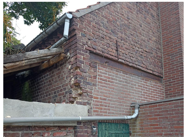
Schade aan metselwerk schuur
