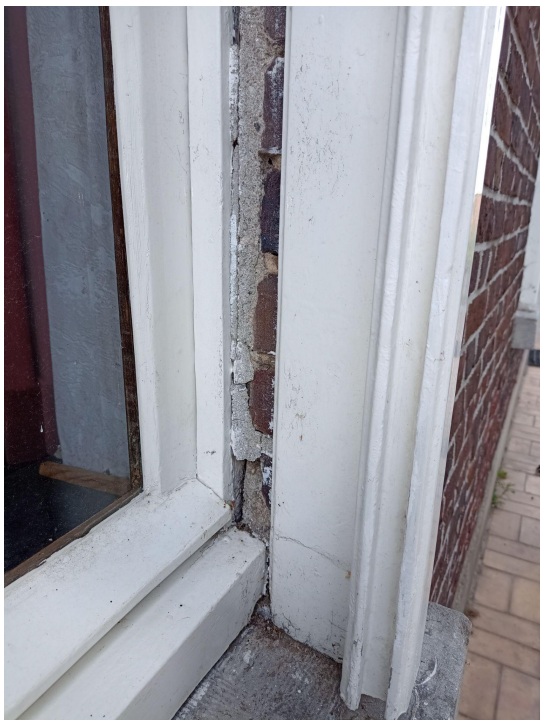
Voeg tussen ramen en muur woonhuis
