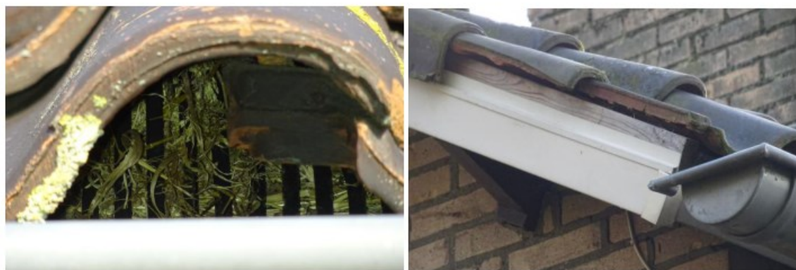
Afbeelding 9 en 10: nesten achter vogelschroot door kapotte dakpannen op de woning. Bron: BNL advies.
