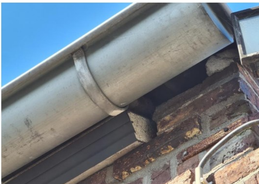
Figuur 3: Kieren bij de dakrand
