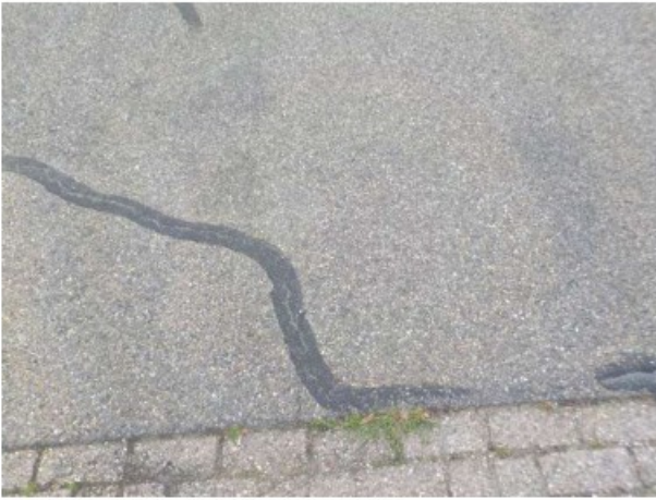
Foto 17. Asphalt Minister Calsstraat
