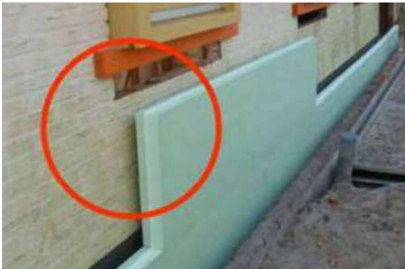
Isolatiemateriaal sluit niet goed aan op het binnengevelblad (bron: Nieman)
