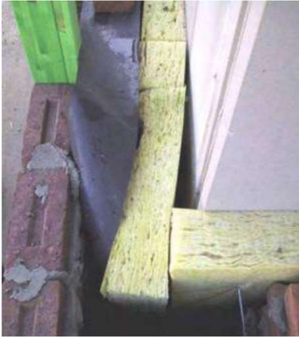
Isolatiematerialen sluiten niet goed aan, hierdoor ontstaat een open hoek (bron: Nieman)
