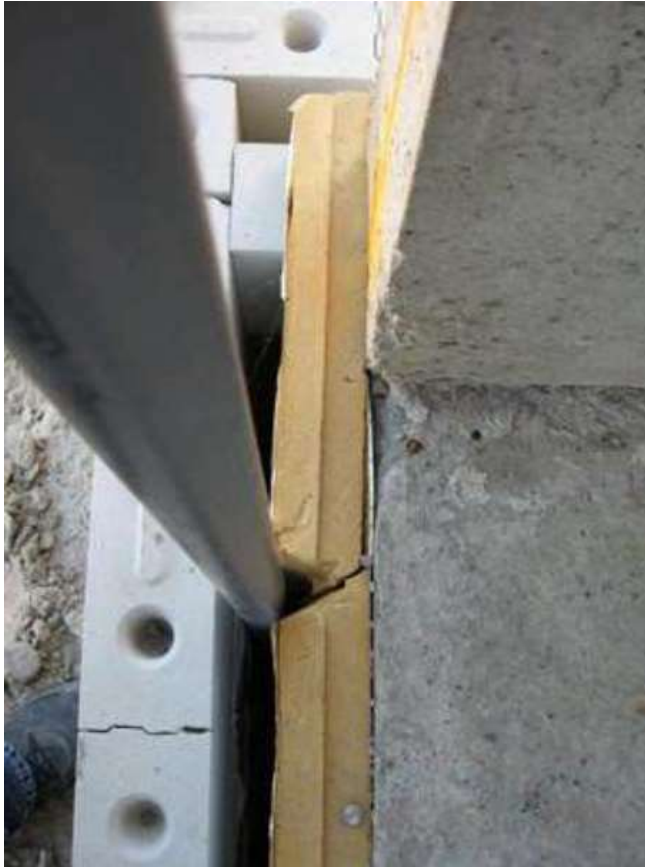
Onderbreking van het isolatiemateriaal
