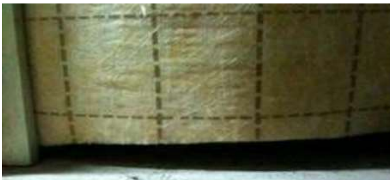
Isolatiemateriaal sluit niet goed aan op de vloer (bron: Nieman)
