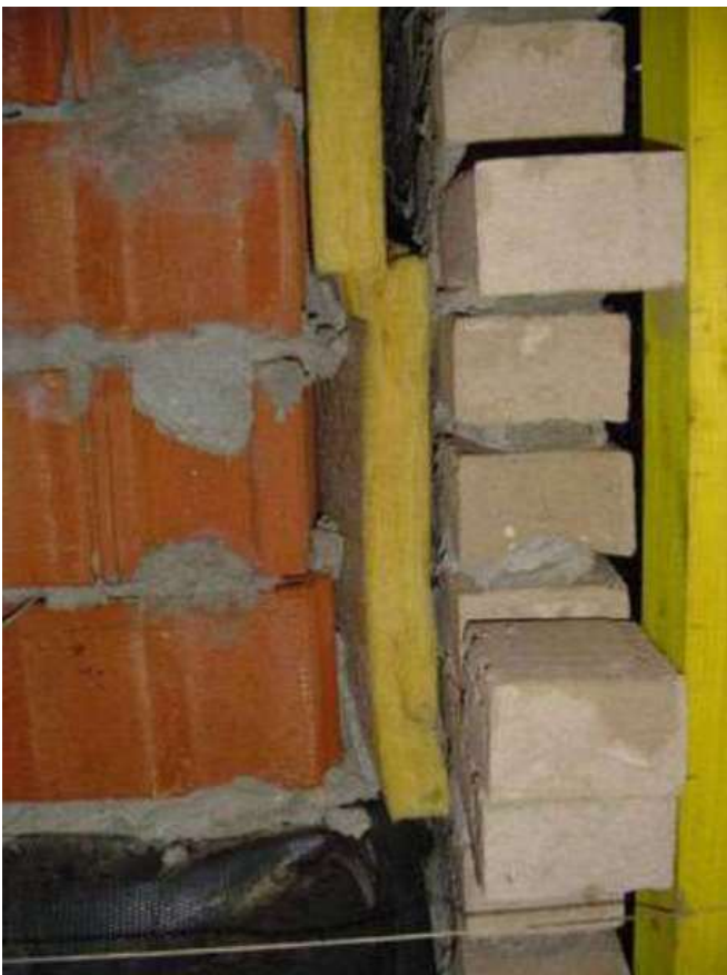
Isolatiemateriaal sluit niet goed op elkaar aan
