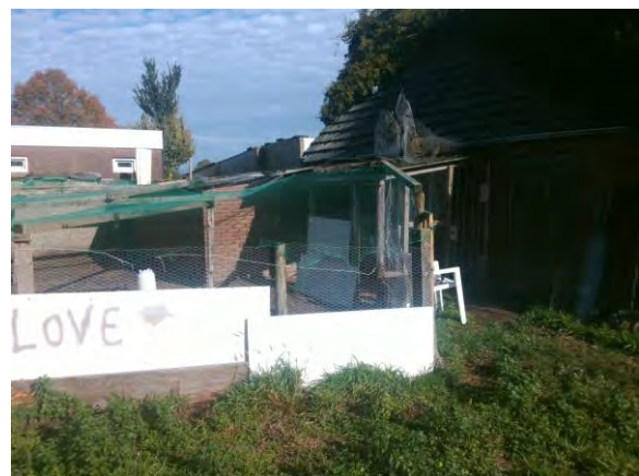
Figuur 9: Asbestverdachte bebouwing
